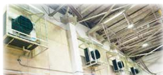
他市の体育館に設置しているスポット式パズーカ型エアコン
