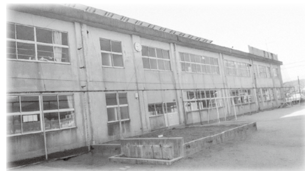
老朽化した校舎(行幸小学校)
