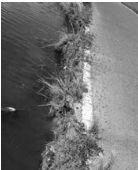
白線の下まで崩壊している道路
