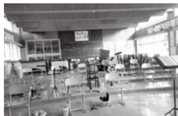
エアコンが設置される音楽教室
