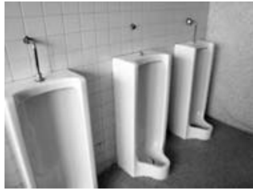
改修が急がれる中学校のトイレ
