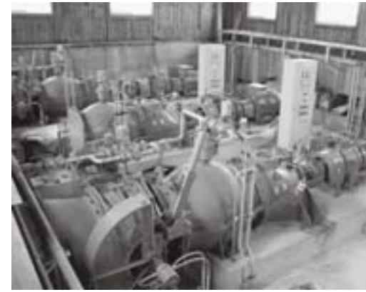
錦海排水ポンプ
