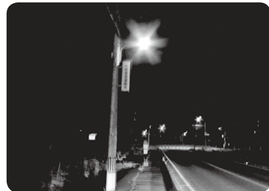
球切れしたスポンサー灯とやむを得ず市費により設置された水銀灯
