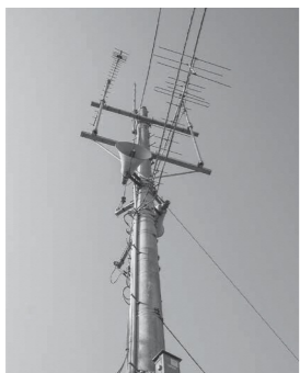
防災行政無線の屋外放送塔
