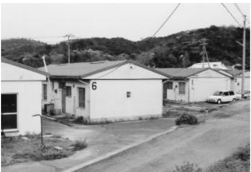
老朽化した弁天の市営住宅
