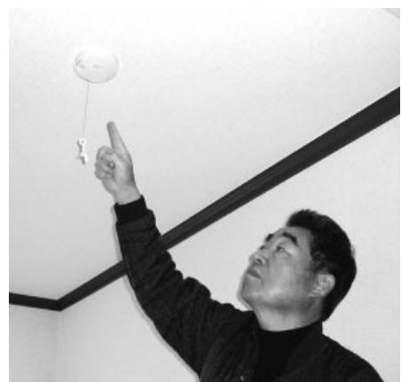
設置した住宅用火災警報器
