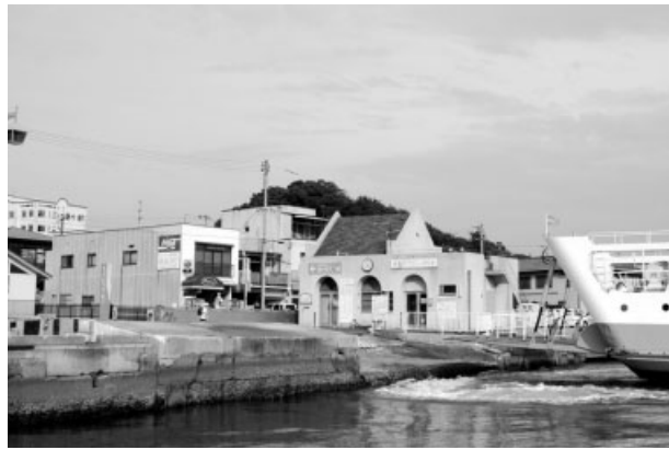
老朽化が進む前島フェリー発着場付近の物揚場護岸
