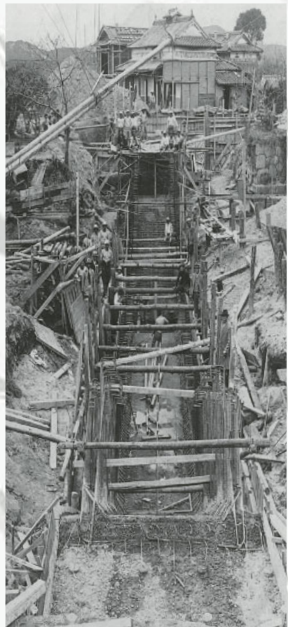
昭和10年ごろの大用水(豆田・四軒家で干田川と交差する地点)の改修工事(写真提供:赤枝貞勝氏)
