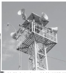
整備された屋外放送設備
