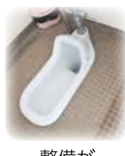
整備がすんでいない和式トイレ
