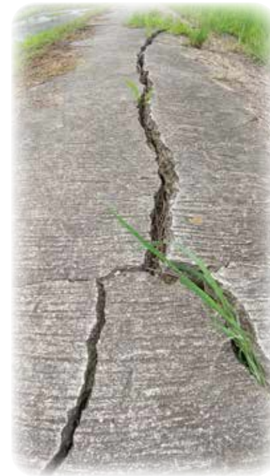
補修が急がれる道路
