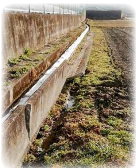
早めの改修が必要な水路
