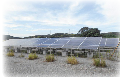
安全に設置されている太陽光パネル
