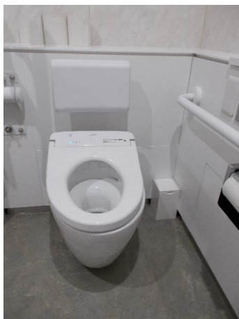
本庁舎西棟1階多目的トイレ
