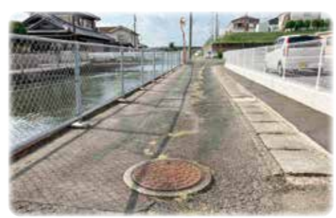
荒れた路面の農道 (大用水沿い)
