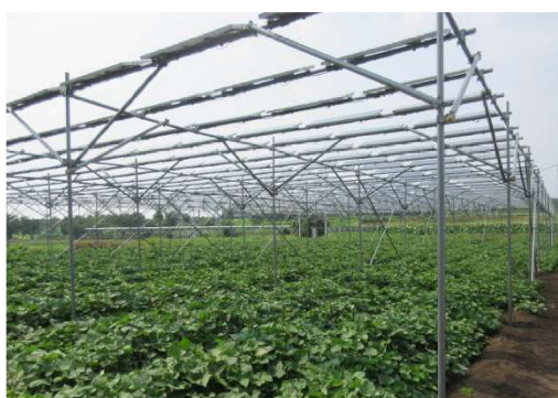
露地の畑の上部にパネルを設置
