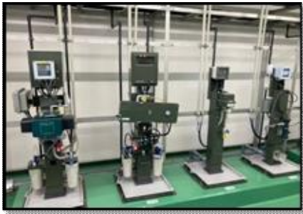
（福山浄水場水質計器）
