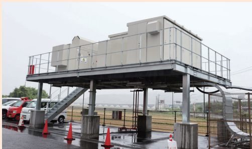
浸水対策を強化した消防本部の発電設備
