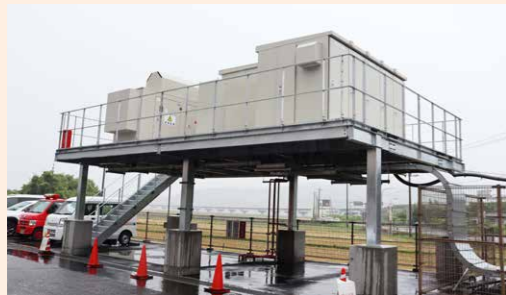
浸水対策を強化した消防本部の発電設備
