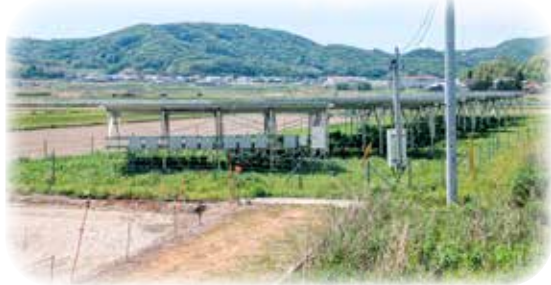
水田の中の営農型太陽光パネル
