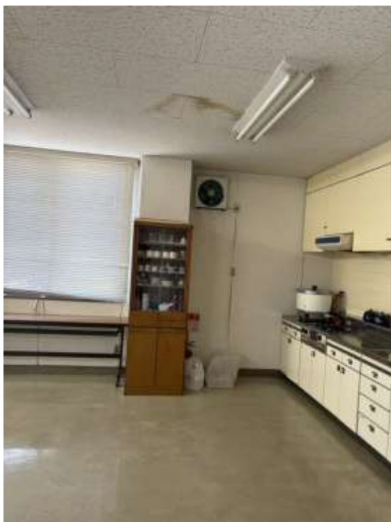
公民館調理実習室雨漏り部分
